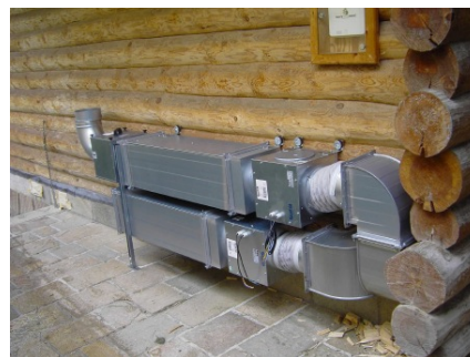
Bild: Wärmerückgewinnung einer Sauna, noch nicht eingekleidet. Rückgewinnungsgrad 80% (Quelle: Inco Ing. Büro Aachen)
